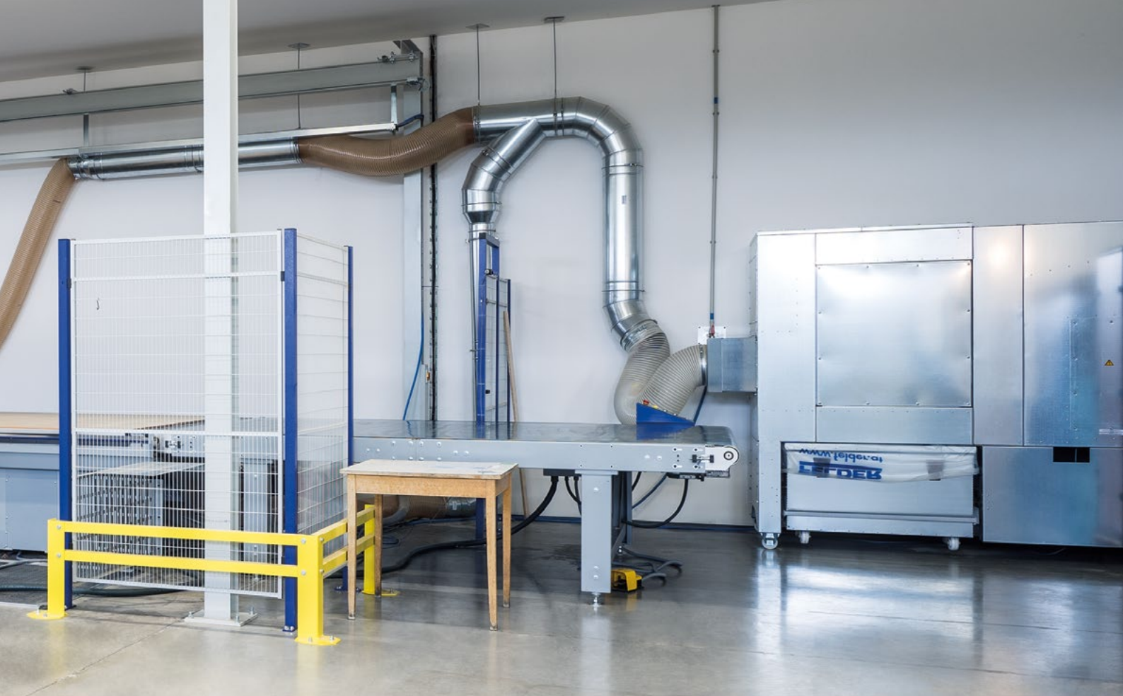
Vollautomatisches Nesting-CNC-Bearbeitungszentrum mit Vorschubapparat
